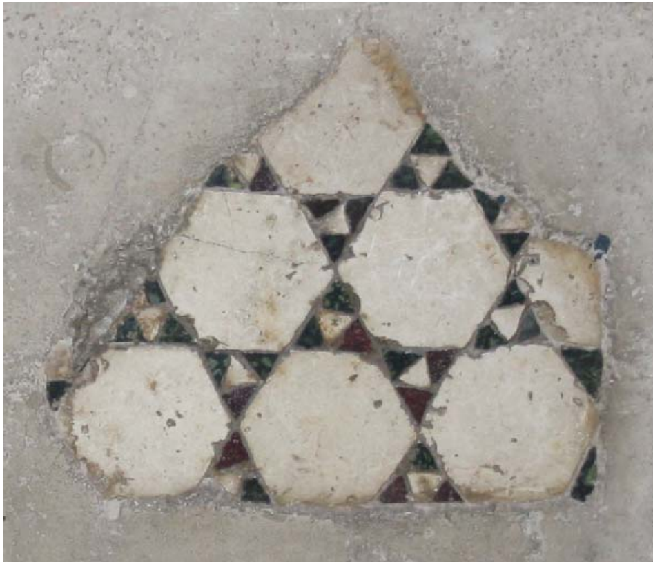
Foto 08 Porzione di pavimento originale con motivi ad esagoni e triangoli. Foto N. Severino
